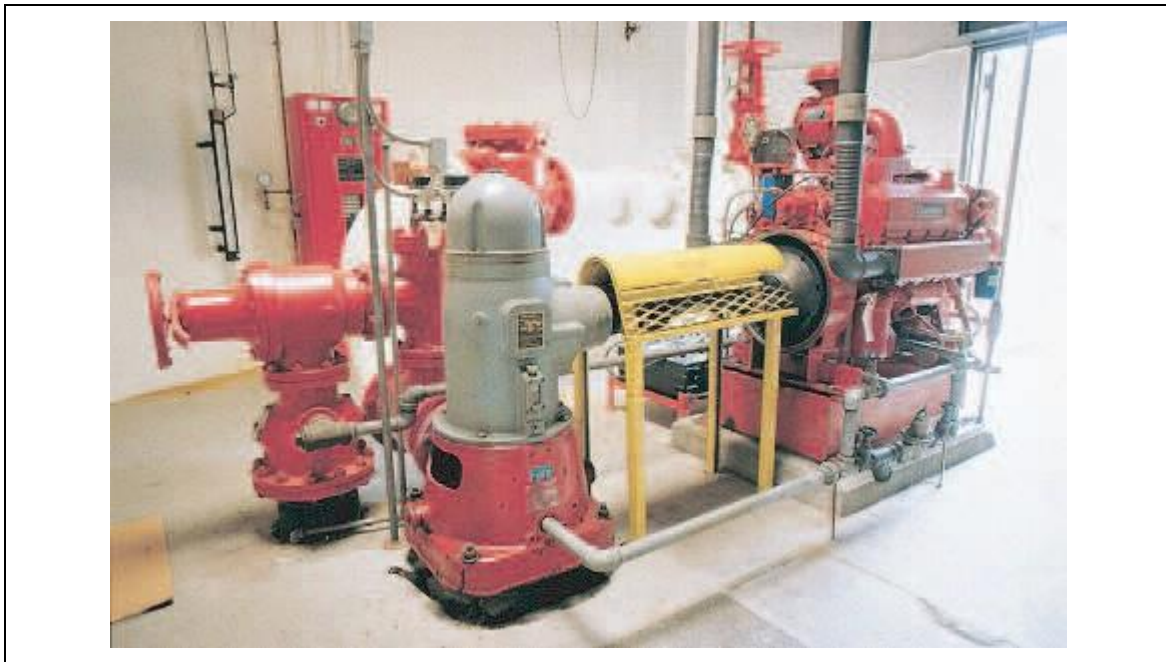
Fig. 2.2.1.2-1. Photo d'un local pompes aménagé de manière satisfaisante
